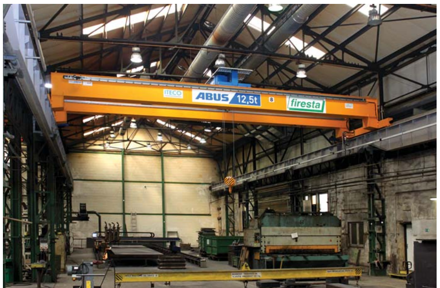
Dvounosíkový mostový jeřáb ITECO-ABUS – ZLK 12,5/12,88 MD v hale svařovny
