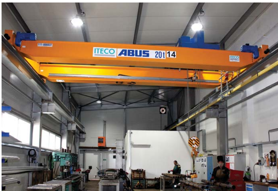
Jednosíkový mostový jeřáb ITECO-ABUS – ELV 5/12,086 D v hale obrobny nad pálicím strojem
